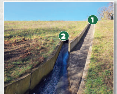
Vue du déversoir de crue et de la sortie de canalisation sur la gauche.
