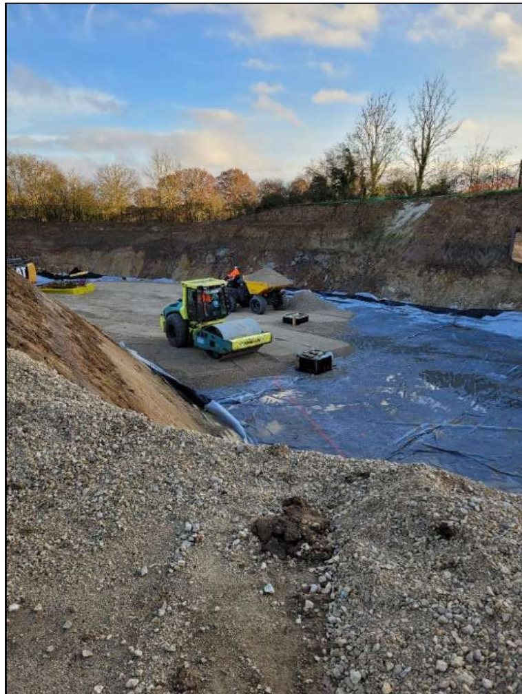
Figure 12 : STEU de La Verrière / Le Mesnil-Saint-Denis Réalisation de la couche de forme au niveau des futurs ouvrages de traitement (source : SIAHVY)
