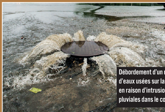
Déversement direct d'eaux usées dans le milieu naturel
